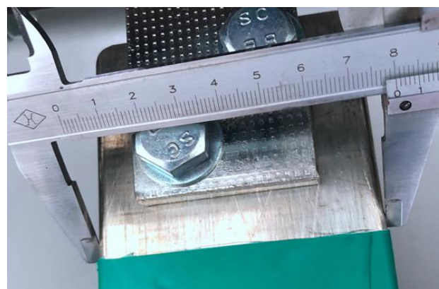
主母排宽度照片
